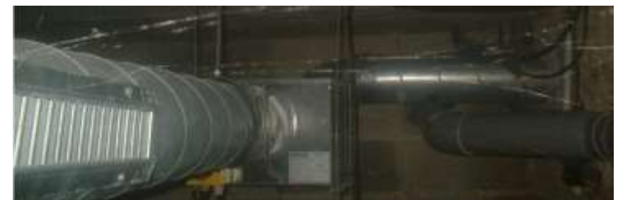
Exhaust fan in technical void
