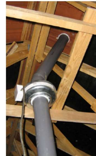
Exhaust fan below roof
