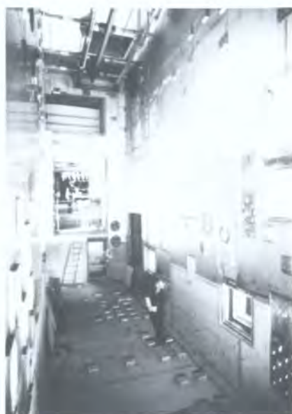
Внутри отсека для остекловывания отходов установки R7, строящейся на заводе по переработке отработанного топлива Ла Аг фирмы „Согема“.
