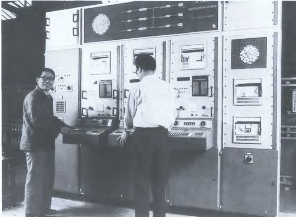
Приборная панель для активной зоны АЭС „Киншан“ мощностью 300 МВт (эл.), строящейся в Китае. (Фото Фраматом)
