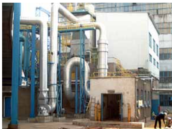
Fig. 1. Installation pilote pour le traitement des gaz de fumée par faisceaux d'électrons à la centrale thermique Maritsa Est 2 (Bulgarie).
