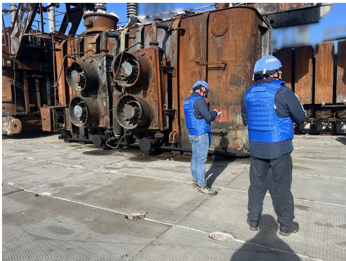
2024 年 10 月 24 日，原子能机构工作人员视察 Dniprovska 750 千伏变电站。 (照片来源：乌克兰国家电力公司)
