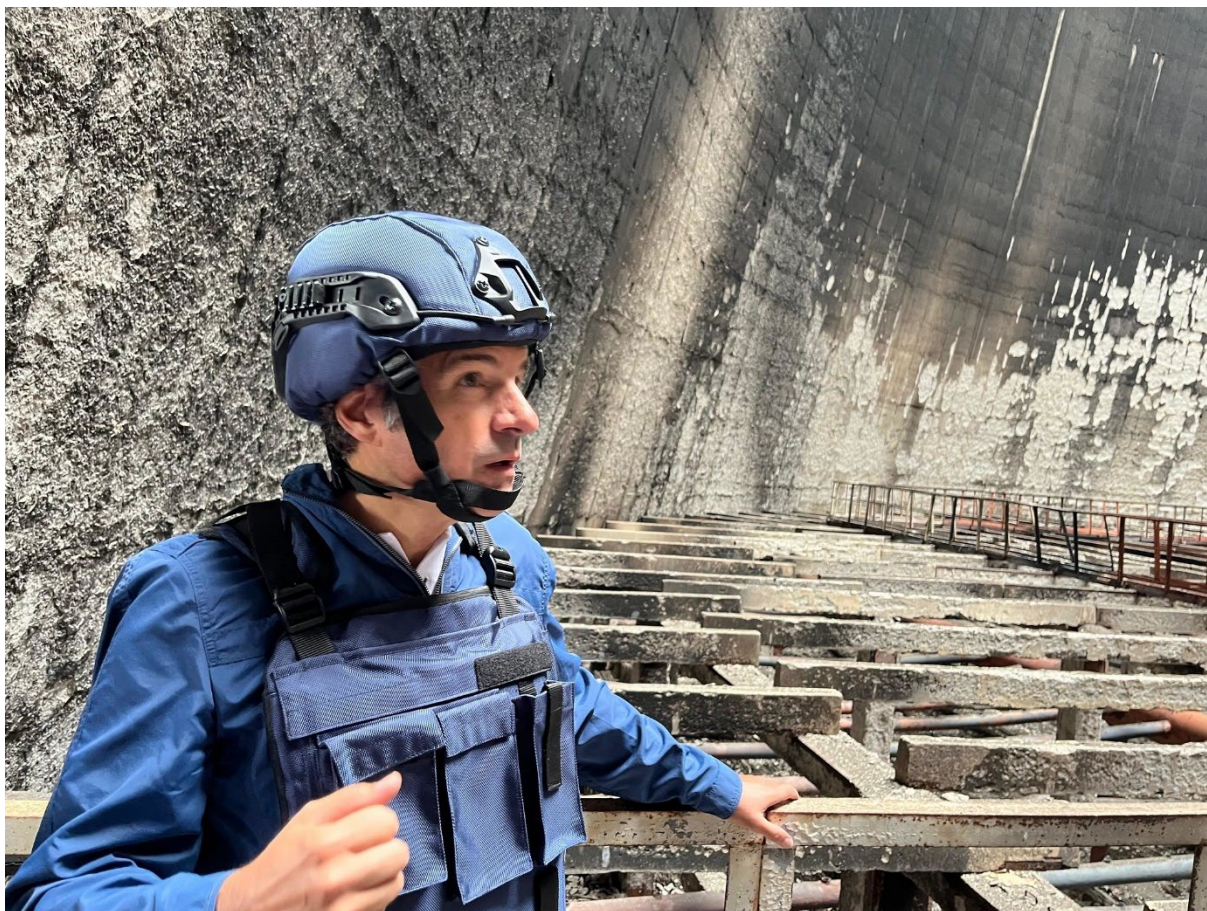
2024 年 9 月 4 日，拉斐尔·马利亚诺·格罗西总干事在乌克兰扎波里日亚核电厂的受损冷却塔前。
