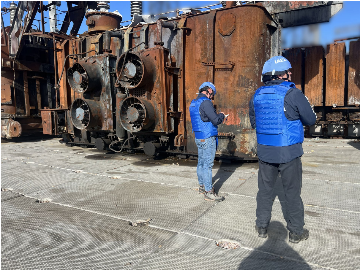
Сотрудники Агентства во время посещения подстанции 750 кВ «Днепровская» 24 октября 2024 года. (Фото: «Укрэнерго»)
