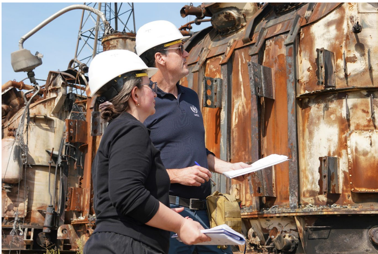
Сотрудники Агентства во время посещения подстанции «Киевская», 12 сентября 2024 года. (Фото: ГИЯРУ)
