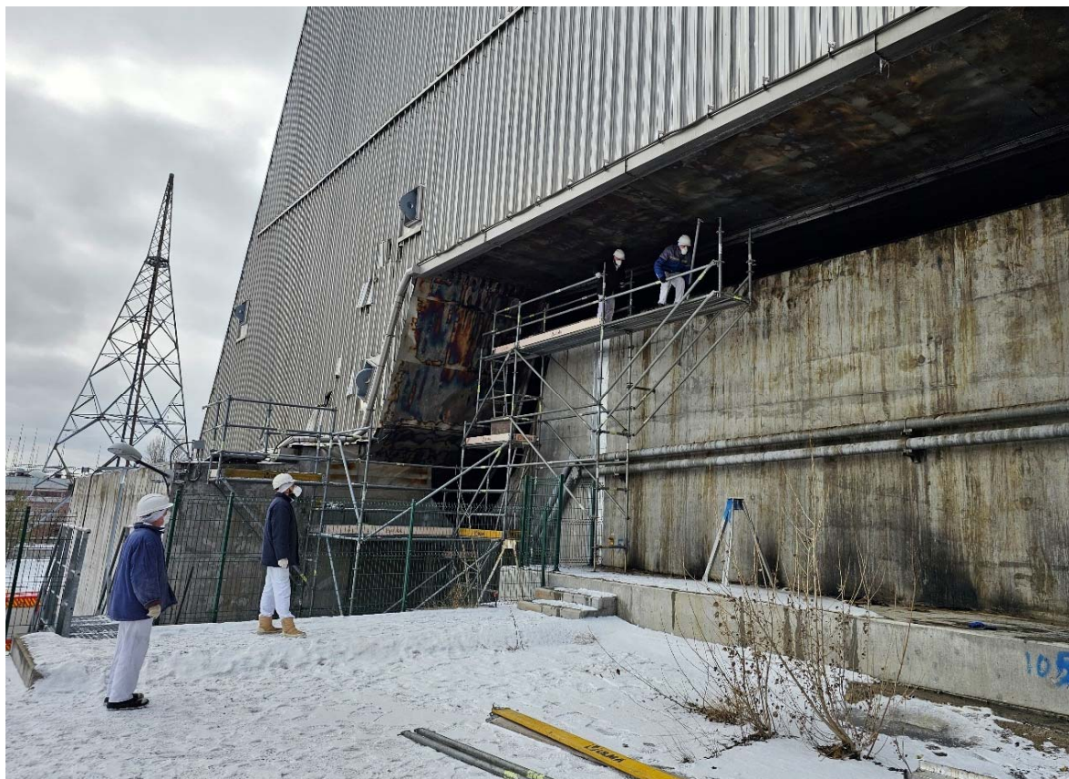
Персонал осматривает повреждение мембраны между контуром арки и бетонной опорной конструкцией НБК 20 февраля 2025 года.
