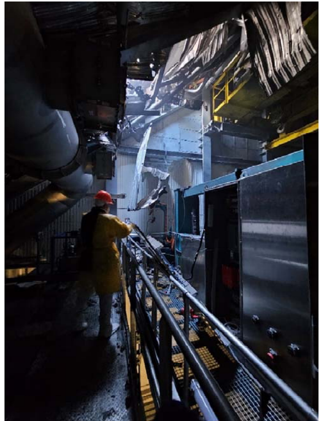
ИСАМИЧ осматривает повреждения внутри НБК 15 февраля 2025 года.
