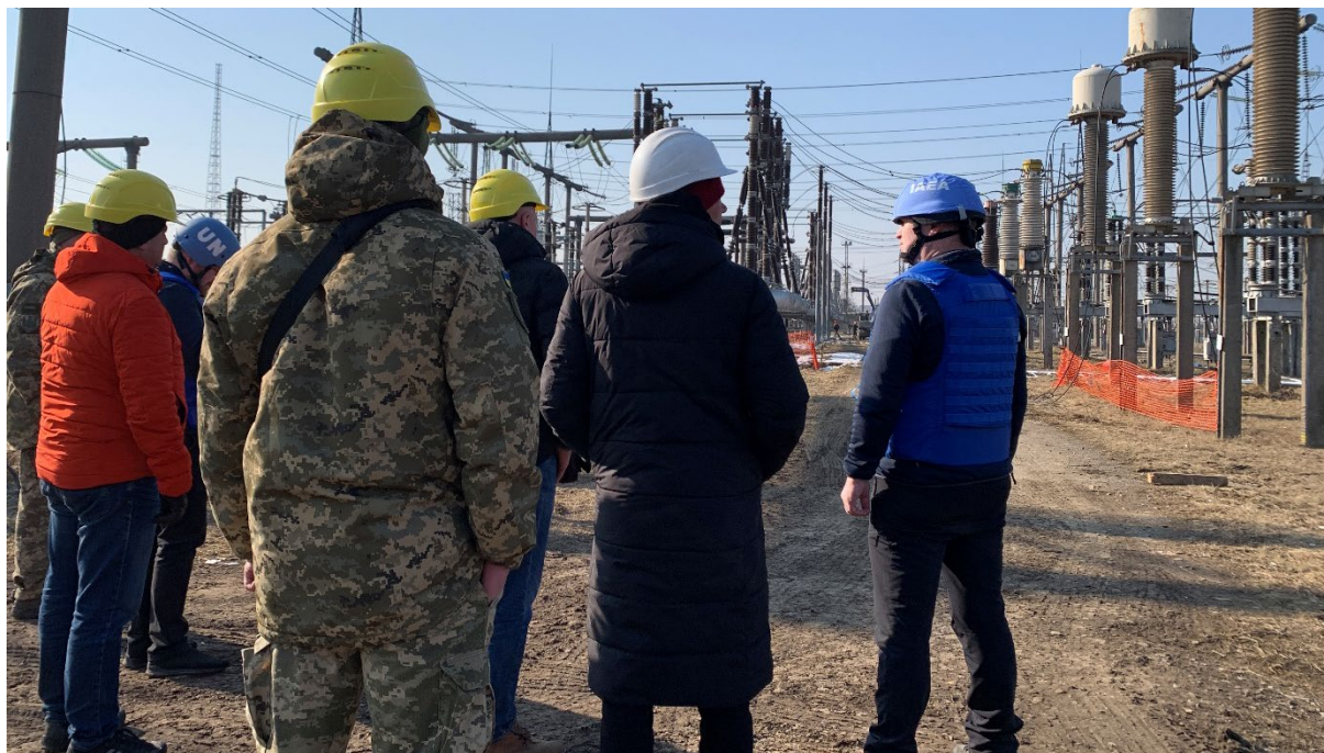
Сотрудники Агентства осматривают одну из критически важных подстанций Украины для оценки повреждений и их влияния на ядерную безопасность АЭС, февраль 2025 года. (Фото: НЭК «Укрэнерго»)
