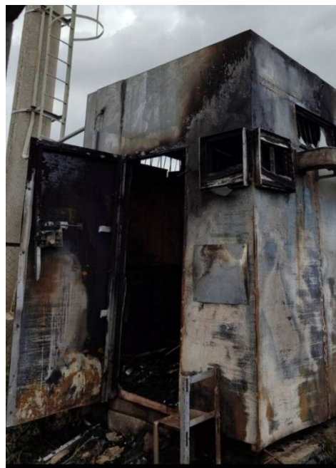
La estación de monitorización radiológica exterior que resultó dañada, situada unos 16 km al suroeste de la ZNPP. (Fotografía: ZNPP)
