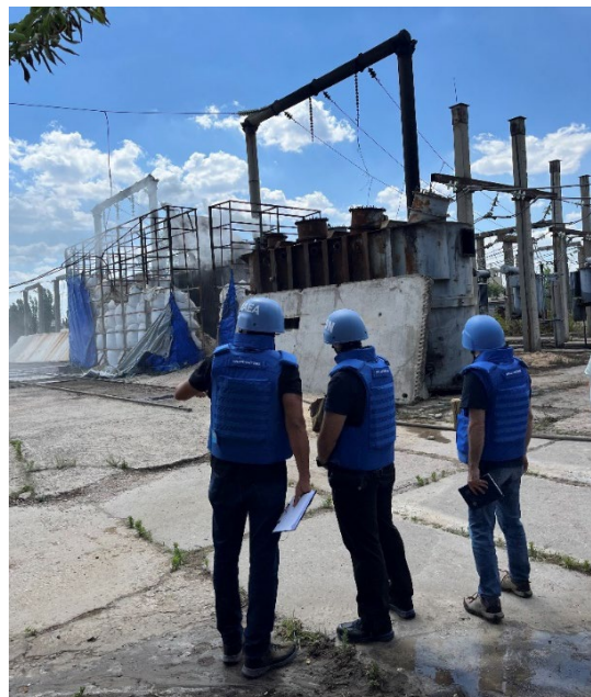
La ISAMZ observa los daños sufridos por la subestación eléctrica Raduga el 20 de junio de 2024.
