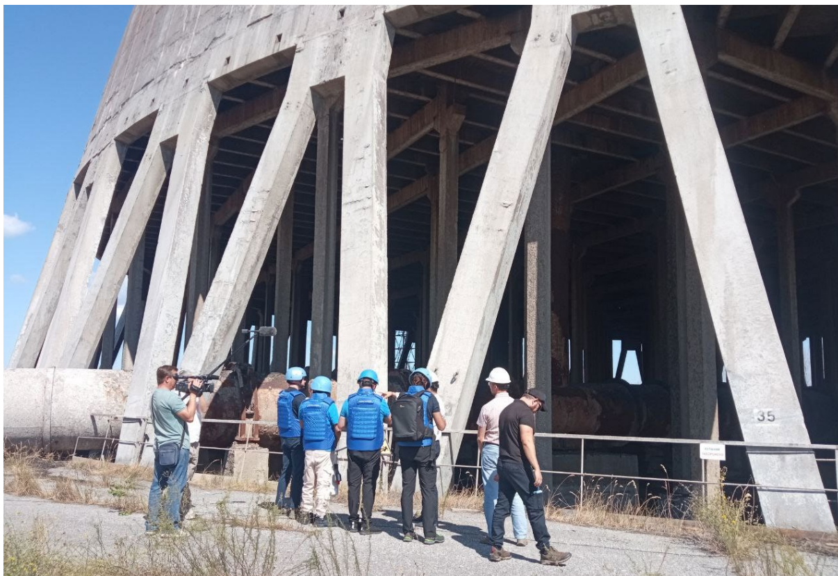
La ISAMZ observa los daños sufridos en la torre de refrigeración el 12 de agosto de 2024. (Fotografía: ZNPP)
